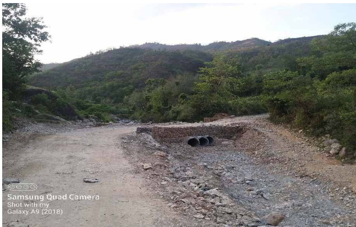
मन्थली गेलु सडकको बफरखोलामा निर्मित पाइप कल्भर्ट, म.न.पा.-८ र ११
